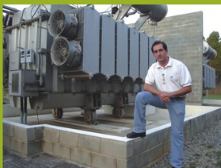
Paulo Chripim - Engenheiro Eletricista responsável pela recepção, transformação e distribuição de energia elétrica para todo o site ZF Sorocaba.
