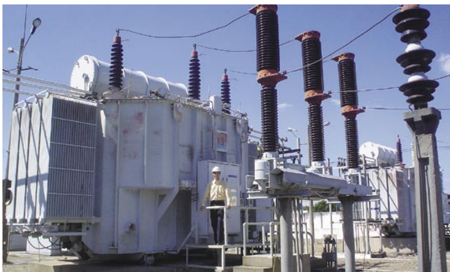
César diante de um dos transformadores da CPFL.
